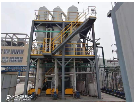
蒸发脱盐预处理装置
