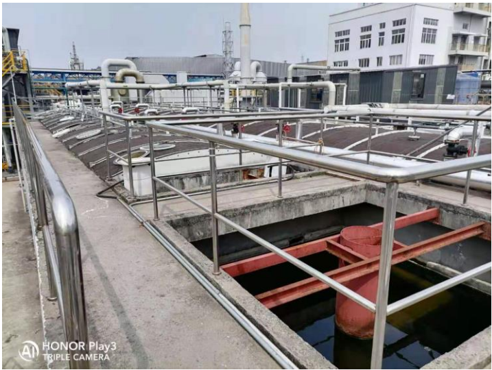
综合污水处理站
