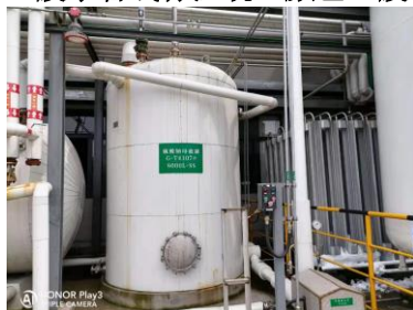
高盐废水母液罐
