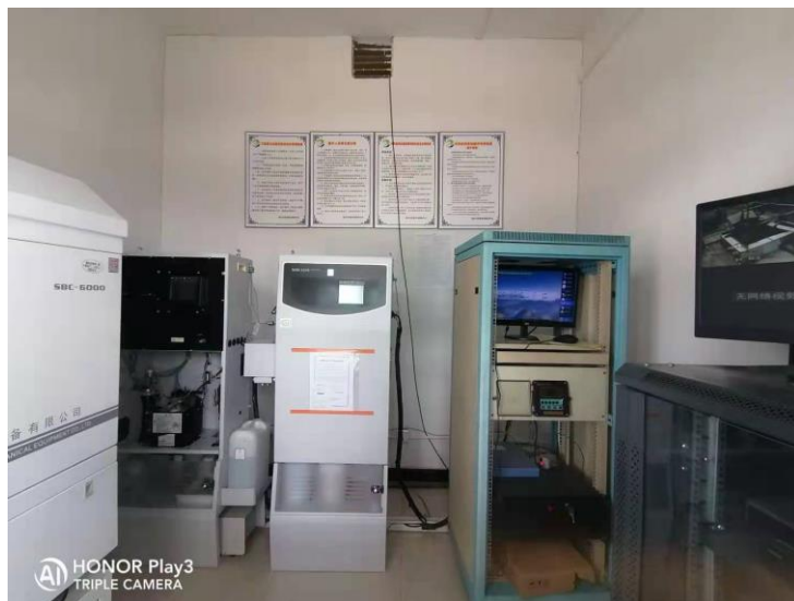
在线监控设施
