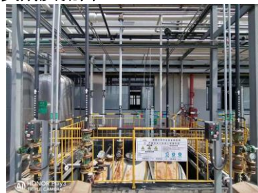
高浓度废水母液罐
