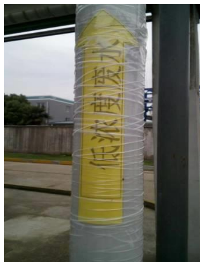
废水管线标注统一颜色、废水类别及流向
