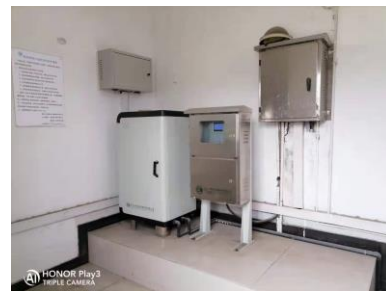
雨水智能化监控设施
