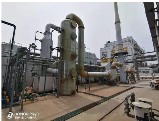
RTO 焚烧装置
